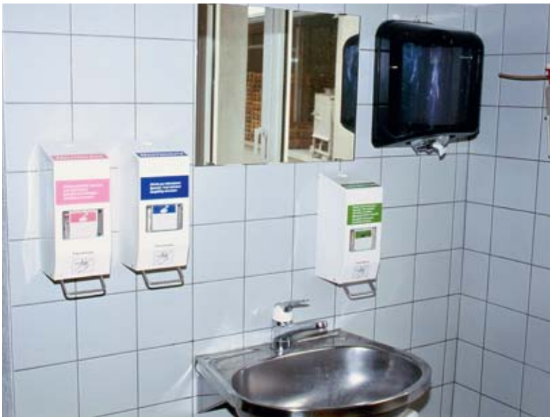
Fig. 18: poste de lavage avec des distributeurs de crème et de savon et une température d'eau réglable dans une entreprise de l'industrie du ciment.
